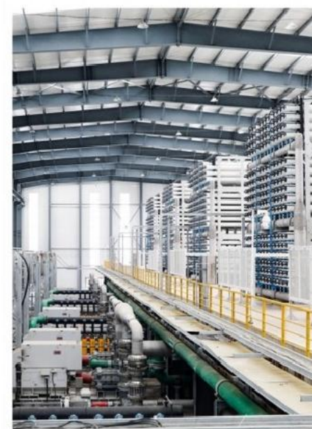
海水淡化 Seawater Desalination
